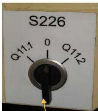
-S226 SPÍNAČ RUCNÍHO OVLÁDÁNÍ PŘEPOJOVAČŮ SYSTÉMU
