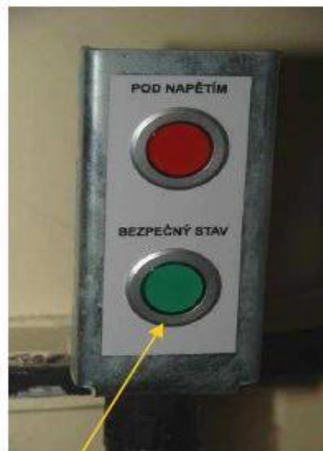
-H205 (-H206) SIGNALIZACE VYSOKÉHO NAPĚTÍ VE STROJOVNĚ
