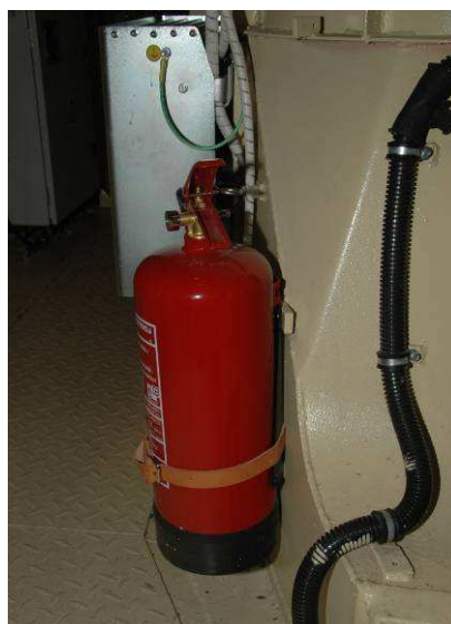
Obr. 56: Ruční hasící přístroj P6KT umístěný v uličce strojovny
