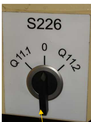
-S226 SPÍNAČ RUČNÍHO OVLÁDÁNÍ PŘEPOJOVACÍ SYSTÉMU
