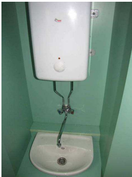
Obr. 68: Ohřívač vody a umyvadlo na stanovišti 2
