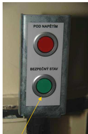
-H205 (-H206) SIGNALIZACE VYSOKÉHO NAPĚTÍ VE STROJOVNĚ
