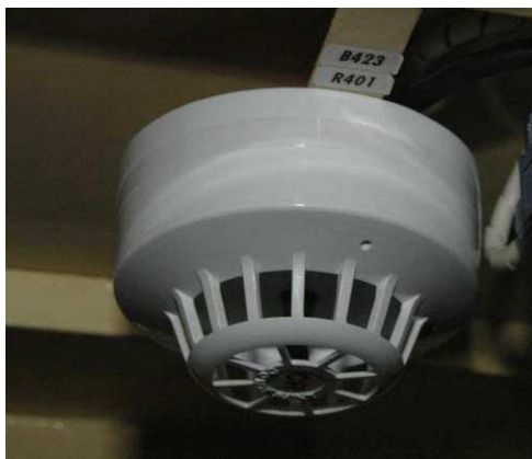
Obr. 54: Detail termodiferenciálního čidla –B423
